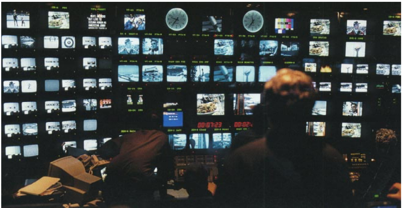
Salle de contrôle au centre de radio-télévision.
